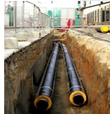
Canalisations de réseau de chaleur
